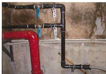
室内入口の汲出管のホースの接続 水色の止水バルブは閉のまま
