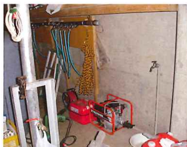
給水ポンプと携行タンクと蛇口盤
