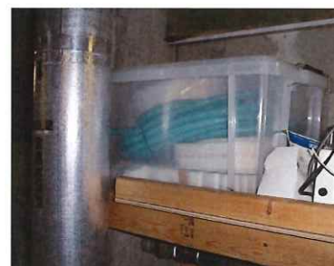
棚の上の消防用ホース
